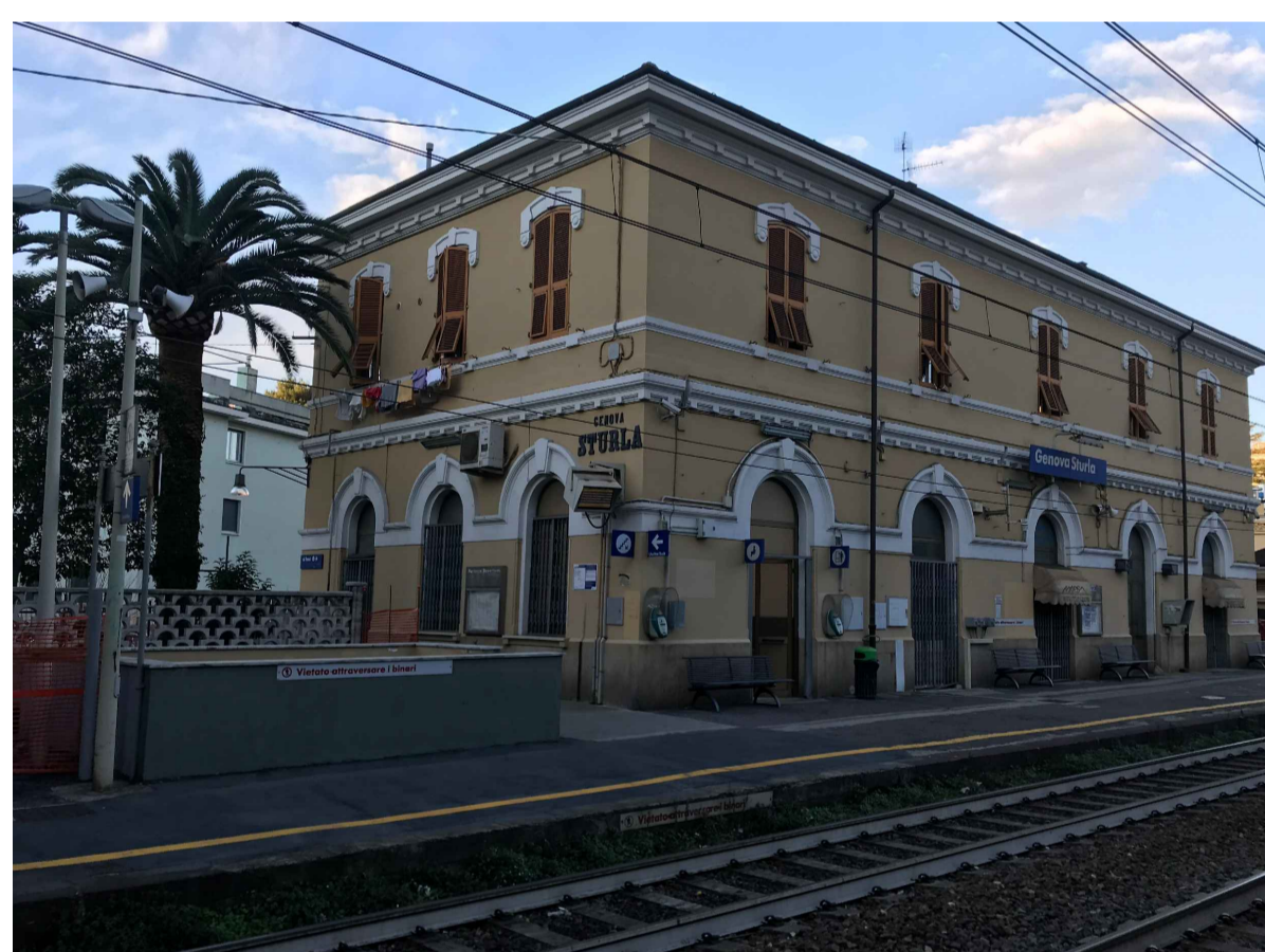
MARCIAPIEDE 1° BINARIO - STATO ATTUALE INACCESSIBILITÀ 2° MARCIAPIEDE H.MARCIAPIEDE +25cm RISPETTO AI BINARI. DIFFICOLTÀ DI ACCESSO ALLE CARROZZE
