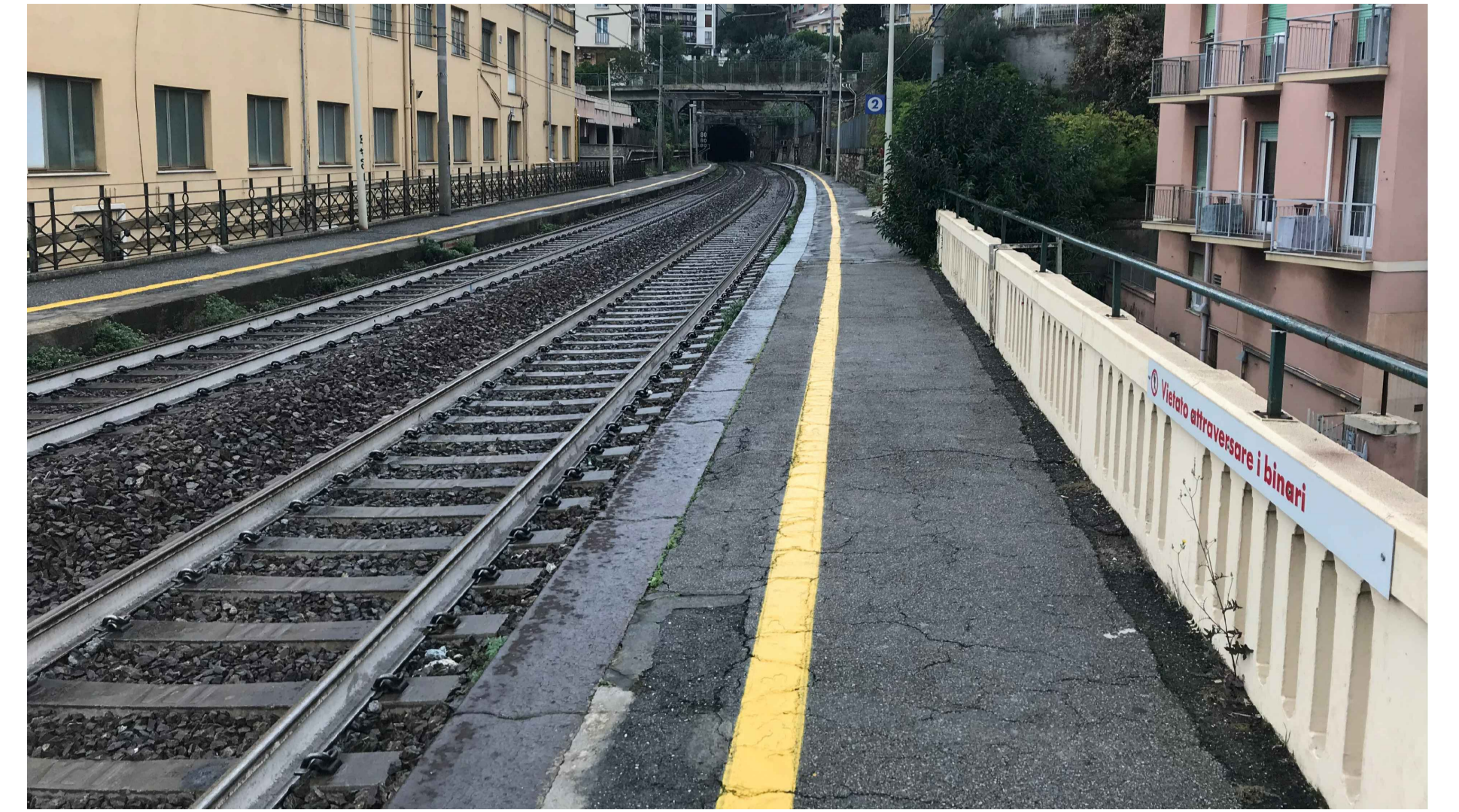
MARCIAPIEDI 2° BINARIO - SOPRAVIA SU VIA ISONZO STATO ATTUALE LARGHEZZA MARCIAPIEDI RIDOTTA SITUAZIONE DI PERICOLO PER VIAGGIATORI H.MARCIAPIEDE +25cm RISPETTO AI BINARI. DIFFICOLTÀ DI ACCESSO ALLE CARROZZE
