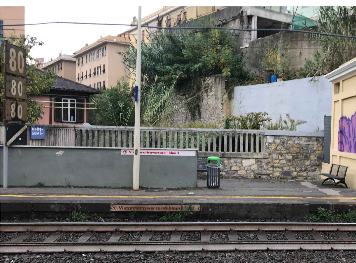
MARCIAPIEDE 2° BINARIO - STATO ATTUALE ATTUALMENTE INACCESSIBILE A DISABILI H.MARCIAPIEDE +25cm RISPETTO AI BINARI. DIFFICOLTÀ DI ACCESSO ALLE CARROZZE
