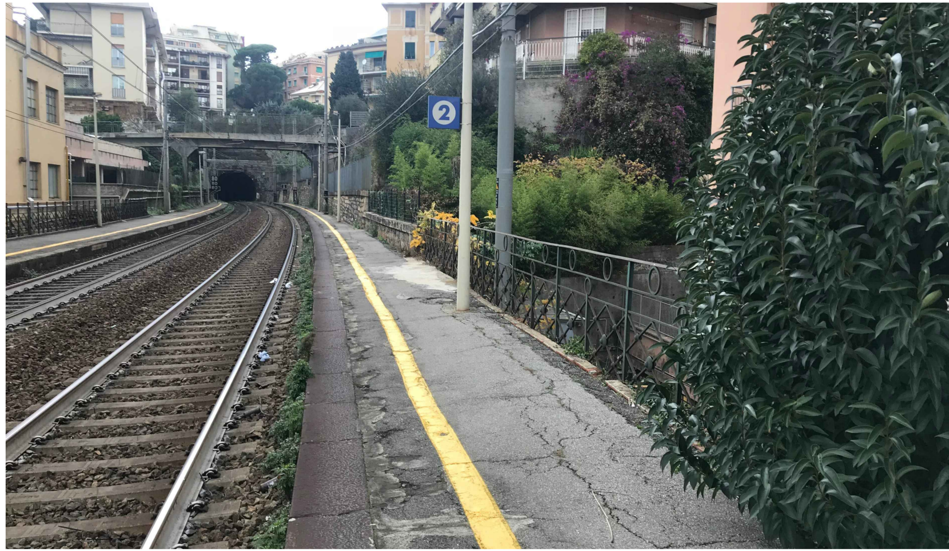
MARCIAPIEDI 2° BINARIO - STATO ATTUALE LARGHEZZA MARCIAPIEDI RIDOTTA SITUAZIONE DI PERICOLO PER VIAGGIATORI H.MARCIAPIEDE +25cm RISPETTO AI BINARI. DIFFICOLTÀ DI ACCESSO ALLE CARROZZE
